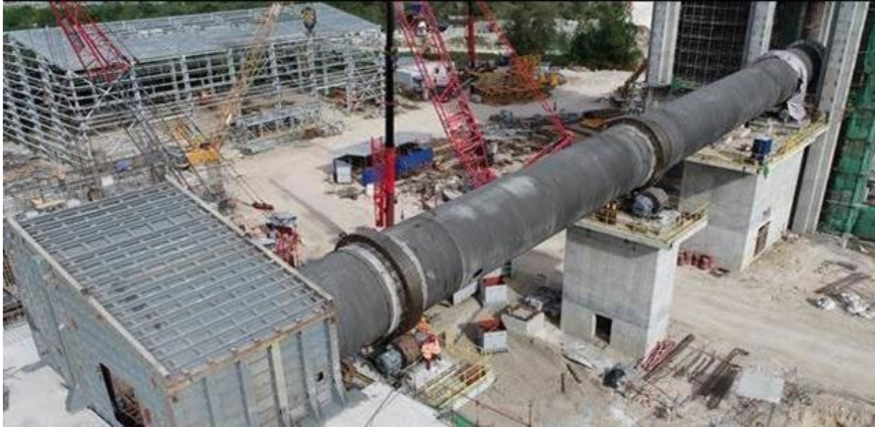
Levantamiento a posición del nuevo horno en la Planta de Cemento Solid (Ene. 2021)
